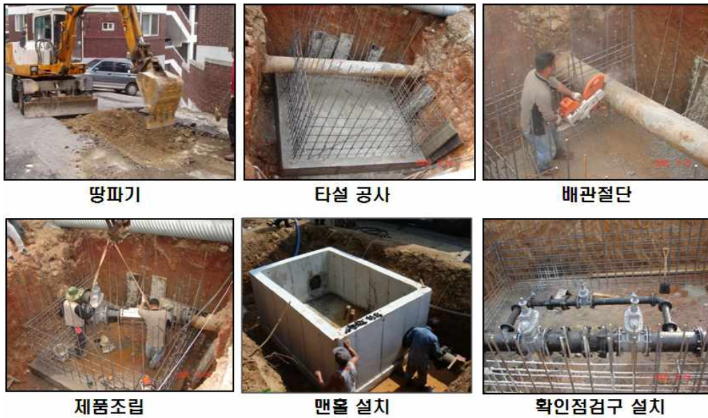
<그림 3-7> 상수관로에서의 이온수처리기 설치
