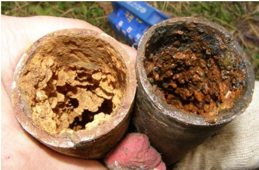
<그림 3-4> 이온수처리기 설치 전후의 관내 스케일 및 녹 변화
