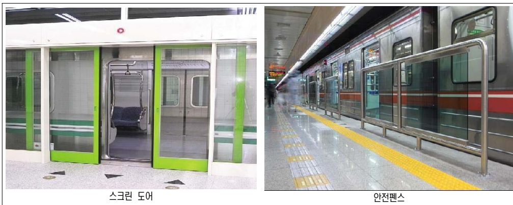
<그림 2-21> 대구지하철 2호선의 승강장 추락방지시설 현황
