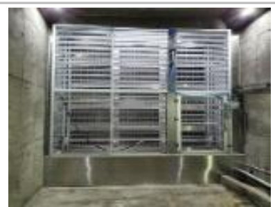
< 터널 환기설비 개선 >
