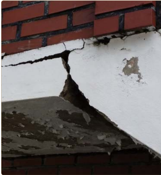
| 시설명 | 주택 | 피해내용 | 2층 계단 하단부 균열
