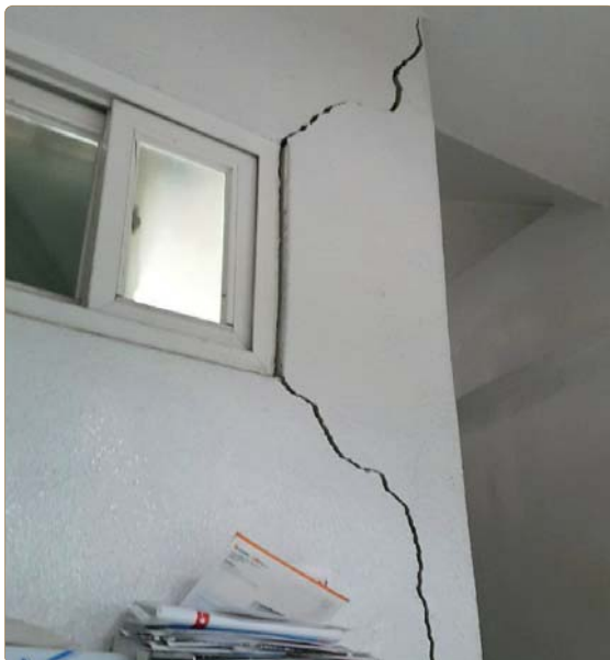
| 시설명 | 주택 | 피해내용 | 주택 균열
