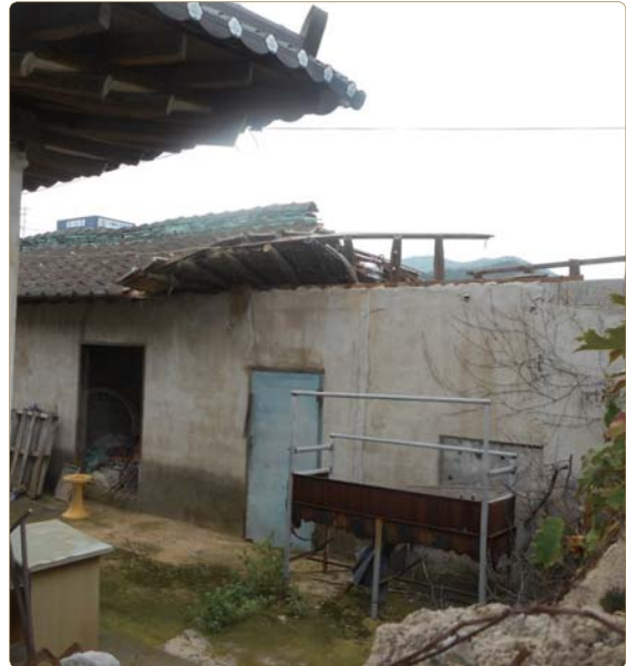
| 시설명 | 창고 | 피해내용 | 창고 지붕 파손
