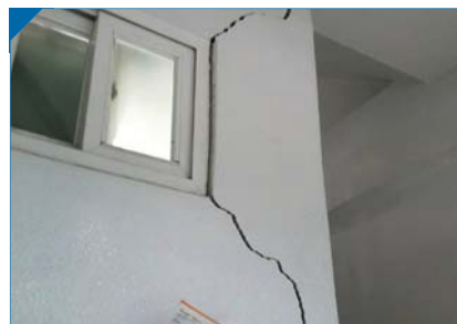
주택 내부 균열
