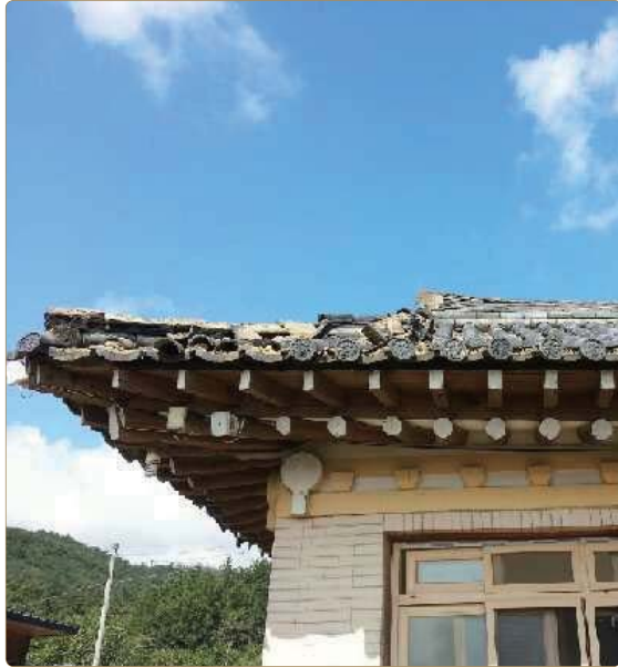
| 시설명 | 도봉서당 | 피해내용 | 지붕기와 파손
