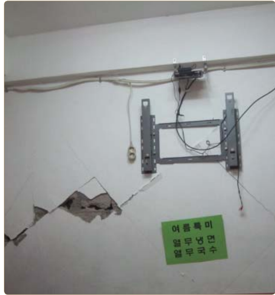
| 시설명 | 성동시장(공설시장) | 피해내용 | 건물 벽체 균열
