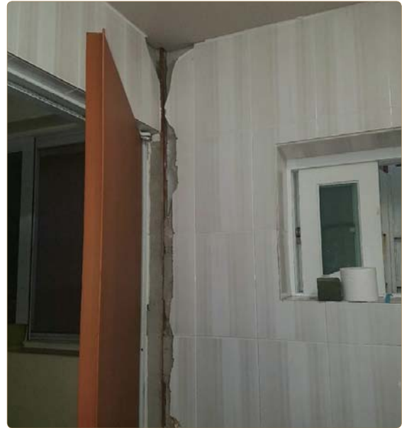
| 시설명 | 주택 | 피해내용 | 주택 균열
