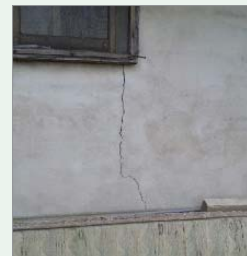
주택 옆면 - 세로균열
