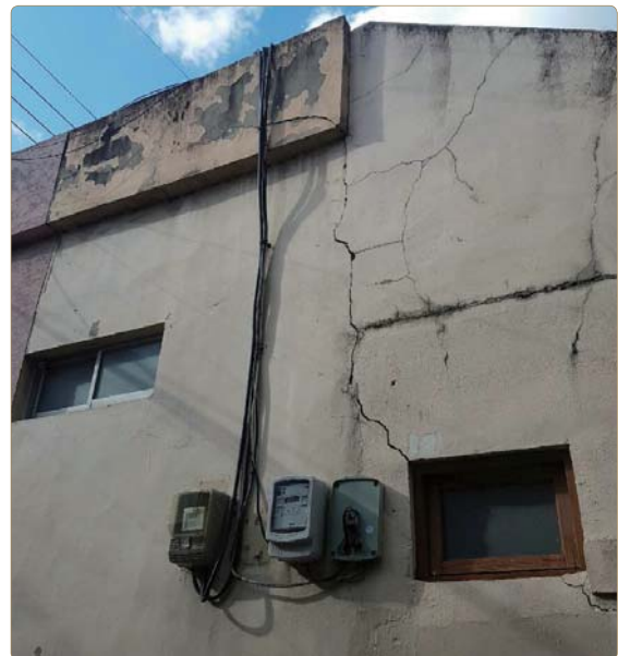
| 시설명 | 주택 | 피해내용 | 주택 외부 균열
