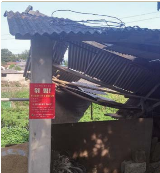
| 시설명 | 주택 창고 | 피해내용 | 창고 파손
