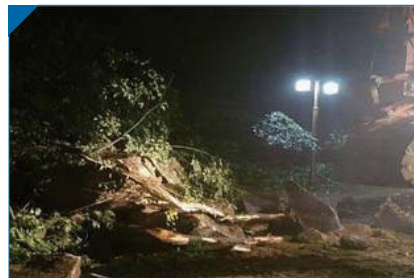
석굴암 진입로 낙석피해
