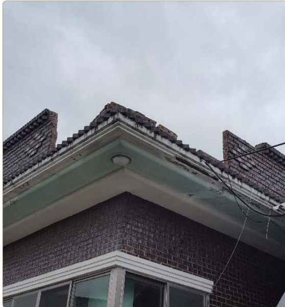
| 시설명 | 주택 | 피해내용 | 지붕 난간 파손
