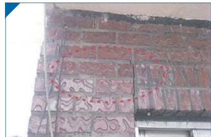
주택 벽체 균열 피해
