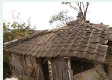
주택 일부 파손
