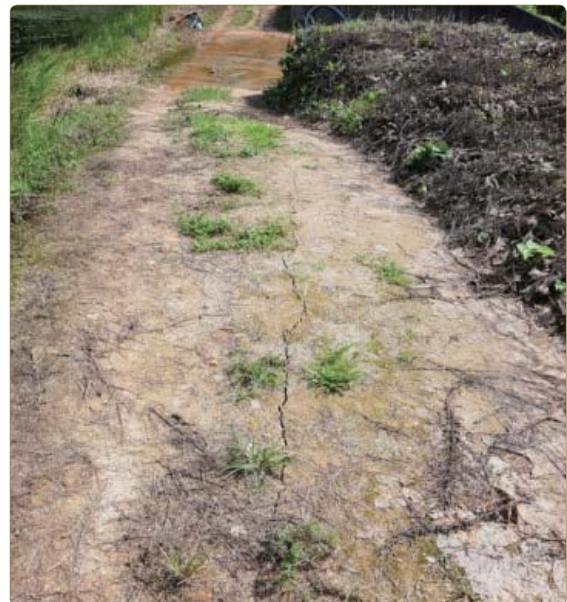
| 시설명 | 사곡지 | 피해내용 | 저수지 둑 균열
