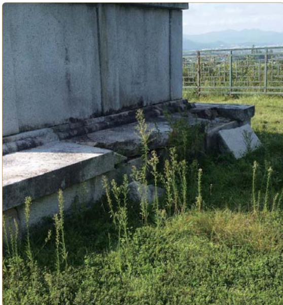
| 시설명 | 창림사지 삼층석탑 | 피해내용 | 하단부 파손
