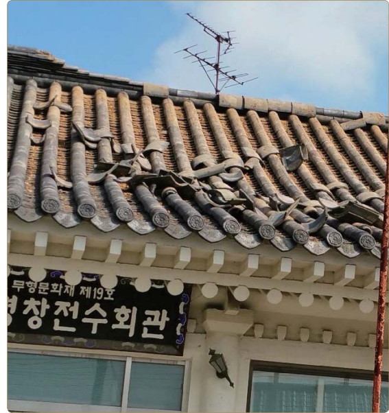
| 시설명 | 가야금병창 무형문화재 전수관 | 피해내용 | 지붕 기와 파손
