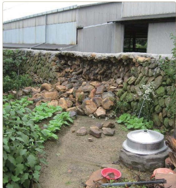
| 시설명 | 담장 | 피해내용 | 담장 파손
