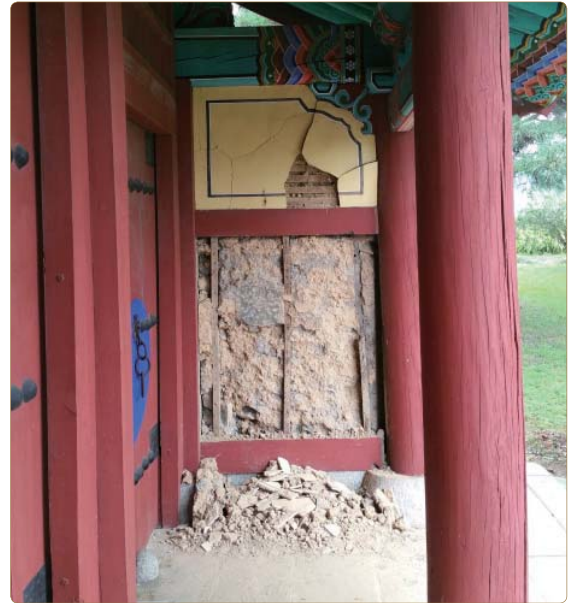
| 시설명 | 신문왕릉 | 피해내용 | 벽체 파손
