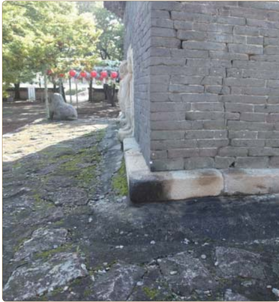
| 시설명 | 분황사 모전석탑 | 피해내용 | 벽체균열
