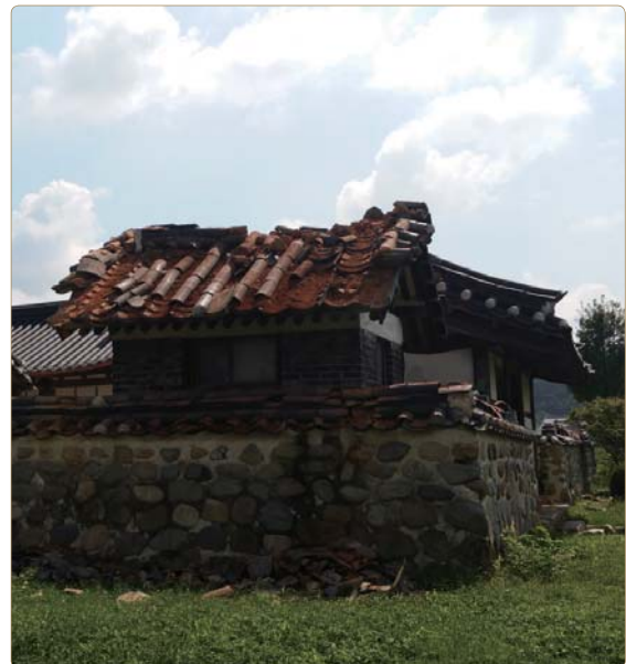
| 시설명 | 사마소 | 피해내용 | 지붕 기와 파손
