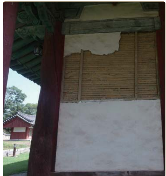
| 시설명 | 경주 향교 | 피해내용 | 벽체 파손
