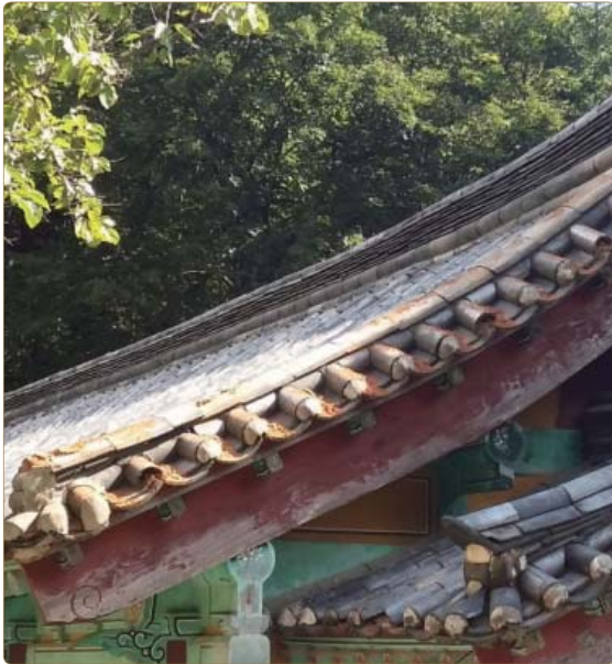
| 시설명 | 석굴암 석굴 | 피해내용 | 지붕기와 파손
