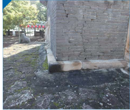
분황사 모전석탑 균열발생
