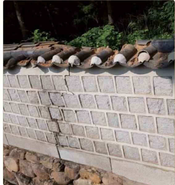
| 시설명 | 통일전 | 피해내용 | 담장 균열 및 기와 파손
