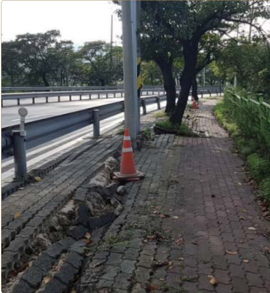
| 시설명 | 산업로(조양교 구간) | 피해내용 | 인터로킹 파손
