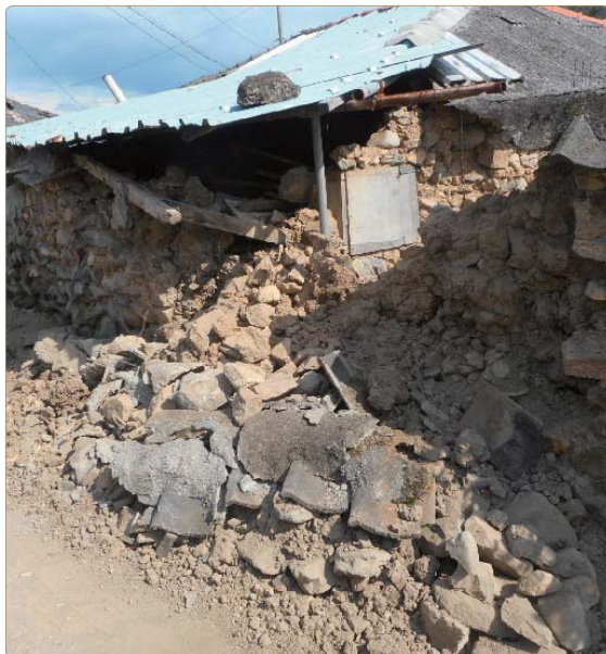
| 시설명 | 담장 | 피해내용 | 담장 파손
