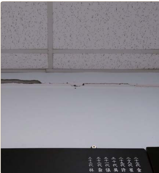
| 시설명 | 울주군 상북면사무소 | 피해내용 | 1층 벽체 크랙
