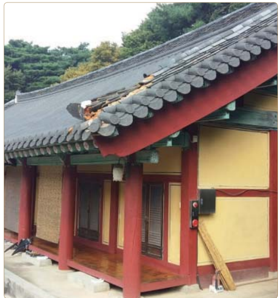
| 시설명 | 불국사 | 피해내용 | 지붕기와 파손
