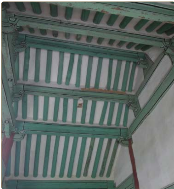
| 시설명 | 향교 대성전 | 피해내용 | 천장파손
