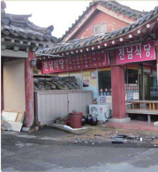
| 시설명 | 불국사 상가시장 | 피해내용 | 지붕 기와파손
